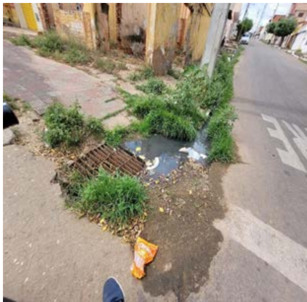
Figura 2 – Problema no sistema de drenagem
