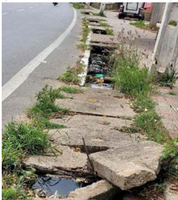
Figura 1 – Problema no sistema de drenagem
