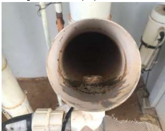
Figura 14 – Extremidade livre onde ocorre a descarga do efluente (R2)
