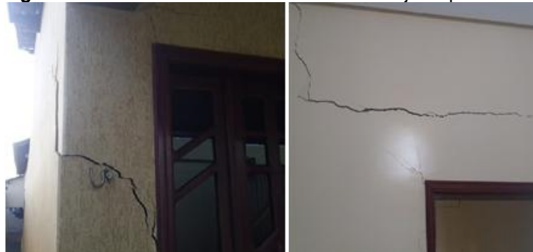
Figura 08 – Rachaduras em residência urbana já inspecionada
