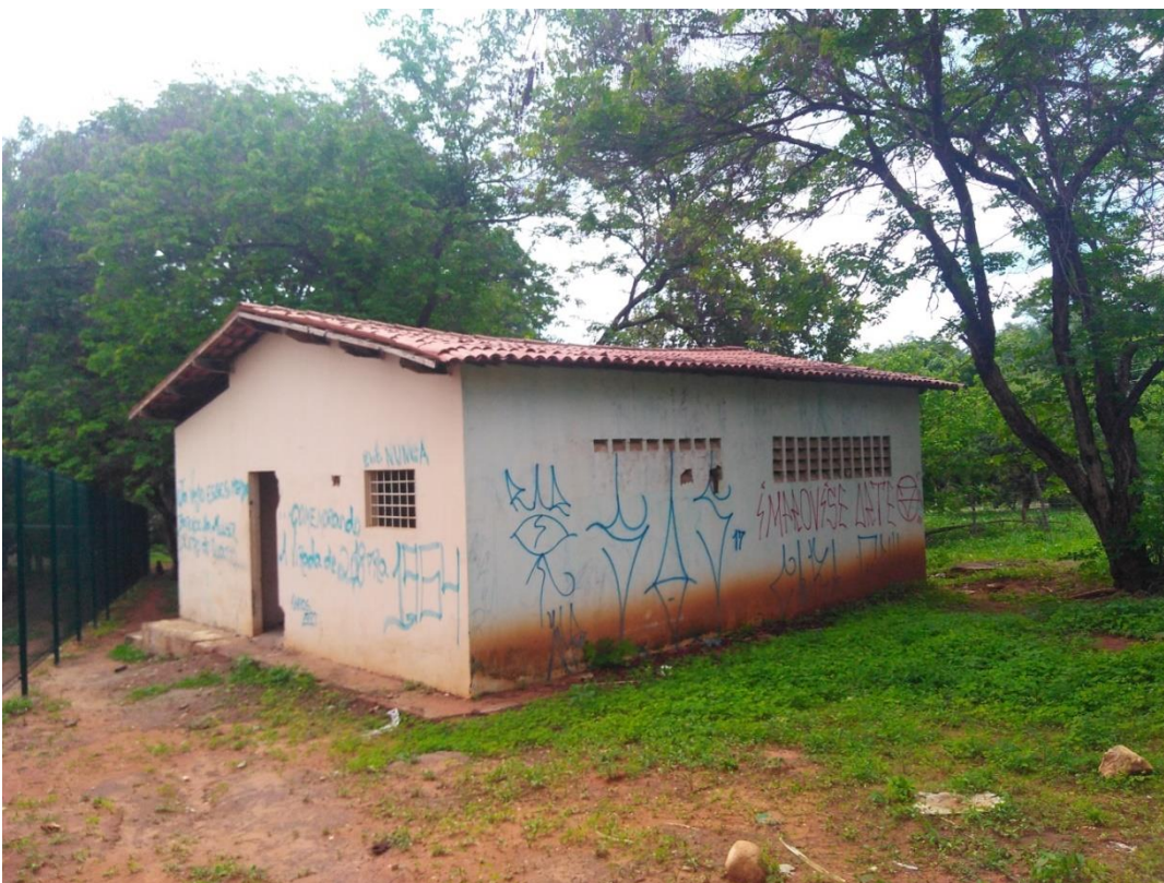
Figura 21 - Construção atualmente abandonada.
