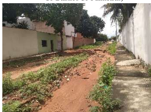
(f) Pt18-Trecho de uma rua totalmente esburacada, cheia de capim e ervas rasteira
