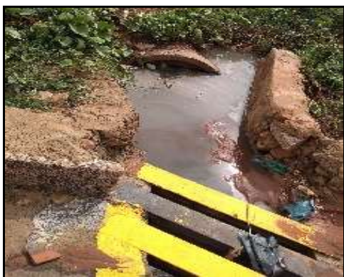
(a) Pt15-Ggaleria obstruída com sedimentos carreados pelas chuvas (2017)
