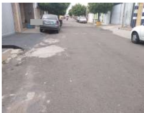
(h) Pt28-Pavimentação em melhor estado
