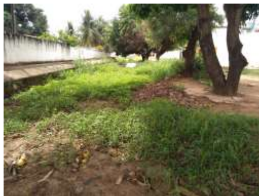
(b) Pt11-Pavimentação toda danificada da rua
