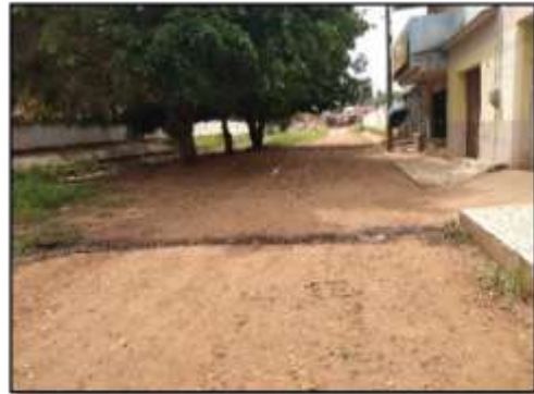
(b) Pt11-Vala por onde escoo o esgoto a céu aberto, infiltrando no solo e pavimentação coberta com solo carreado pelas chuvas, além de buracos em todo o percurso
