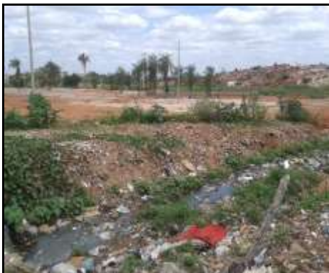
(e) Vala escoando esgoto doméstico vindo da rua São Mamede e desembocando no riacho dos Macacos
