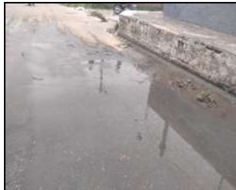
(d) Av. Jose Bezerra com esgoto empossado, lavando a avenida
