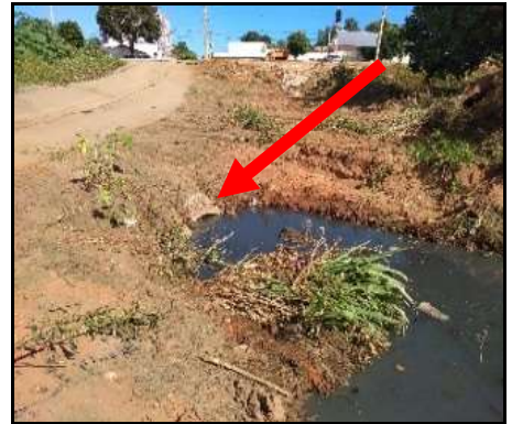
(d) Pt4-Poluição pontual com esgoto pelas tubulações da drenagem
