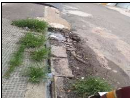
(c) Pt20-Meio fio com esgoto obstruído, danificando a pavimentação
