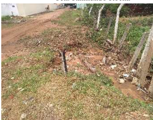
(e) Pt18-Início de processo erosivo no canal de drenagem natural que corta a rua Beato Lourenço
