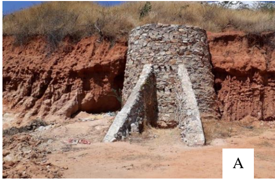
A – Muro de pedra para contenção de área com declive acentuado e presença de sulcos erosivos em sua vertente
