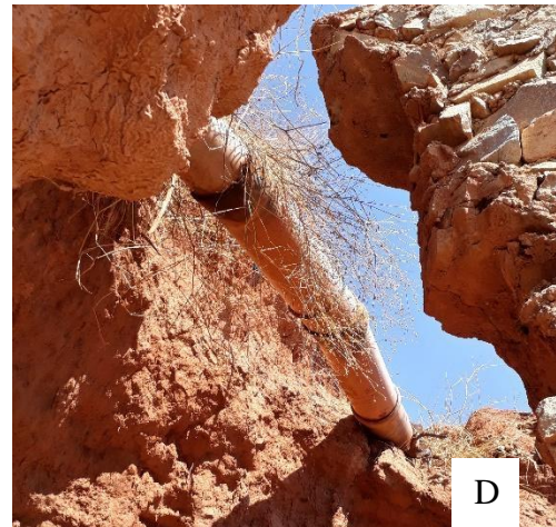
D – Tubulação exposta na parte interna do muro de pedra, provavelmente em decorrência da ação erosiva das águas pluviais.
