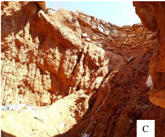
C – Visão da área interna do muro de pedra, podendo-se ver a erosão acentuada e o seu afastamento da encosta
